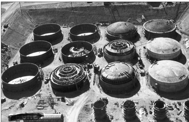
Obr. 44.7 Fotografie výstavby podzemního úložiště cisteren v Hanford Site ve státě Washington během 2. světové války. Všimněte si nákladních aut a dělníků. Každá z velkých cisteren pojme téměř 1 000 m 3 vysoce radioaktivního tekutého odpadu.
